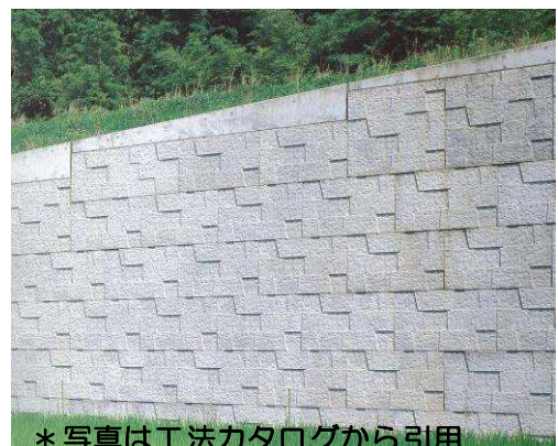
背後にシート (ジオテキスタイル) が 入っているコンクリートの壁
