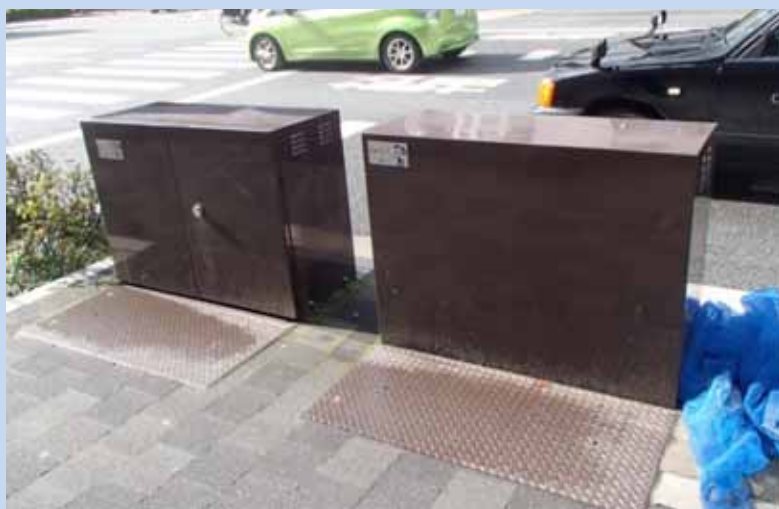
地上機器の設置状況(歩道上)
