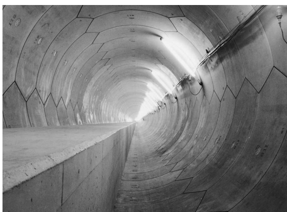
■ハニカムセグメントを用いて二次覆工を省略した雨水管渠
