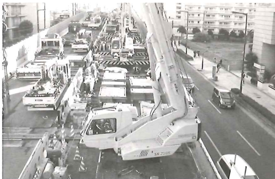
■わが国初となる1支承線化による連続化工事の作業状況
