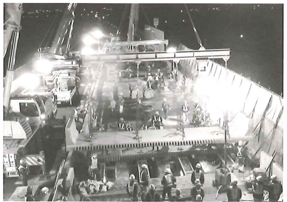
■高速道路で初めてとなる夜間施工・昼間開放による施工条件下での床版取替状況
